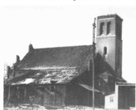
In dieser Kirche – Willkischken – soll bis Juli 1993 Getreide lagern. Die Turmspitze wurde 1987 wegen Einsturzgefahr abgetragen.
