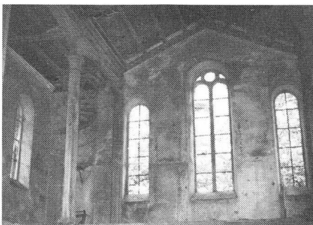
Auch das Dach der Kirche ist reparaturbedürftig. Bilder (2) M. Rilli
